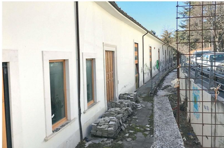
Così è ridotta la ex sede dello Scientifico in via Maiella, di proprietà del Comune
