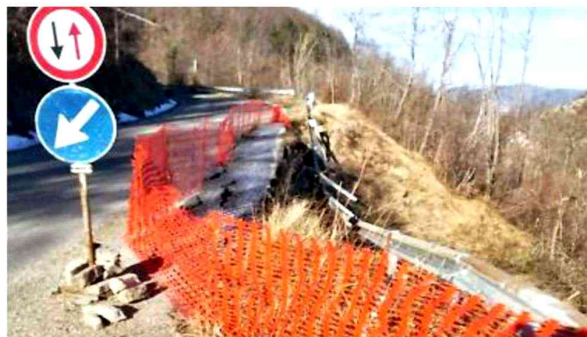
Nella zona di Verghereto la frana sulla Sp 130 a Riofreddo
